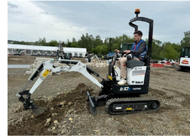
Patrik Eder bei der Bedienung des Minibaggers E10e Bildquelle: Doosan Bobcat EMEA zfg
